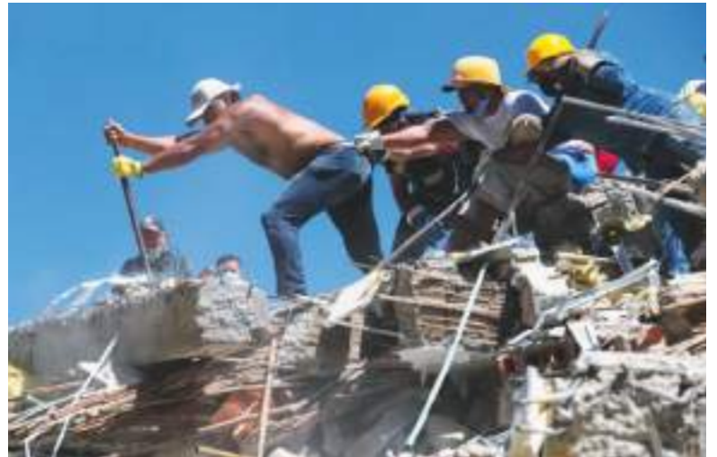
Equipos de rescate reaccionan tras el terremoto en Manizales.
